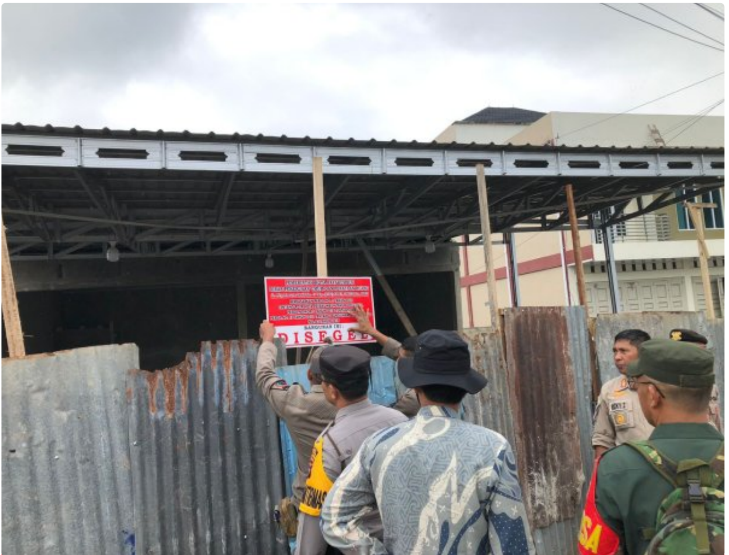
Menyalahi Aturan LP2B, Ada 5 Bangunan Disegel Dinas PUPR
